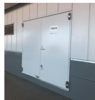
機器室の防水扉
