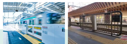
ホームドア・センサー付固定式ホーム柵の設置100%達成（2020年）
